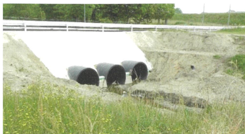
里の森ゾーン・ふれあいゾーン間の市道下にできた3本のコルゲート管と水路周辺
